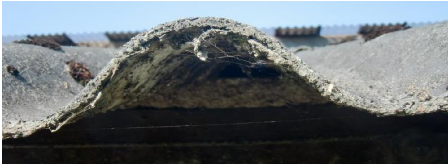
Verweerd asbestdak zonder dakgoot
